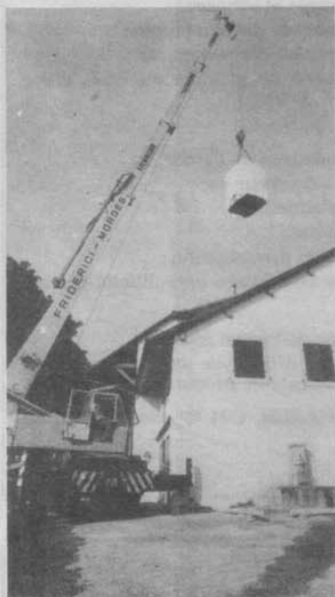
Par le toit, une des cuves de 5 400 litres a précédé le pressoir. (Photo Serra)
